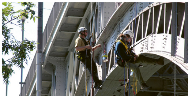
1 Les travaux sur cordes sont toujours exécutés avec une corde de travail et une corde de sécurité.
