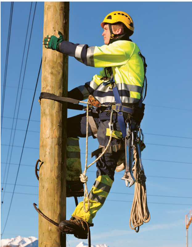
6 Freileitungsmonteur besteigt mit Steigeisen und Masthaltegurt einen Holzmast. Hier ist kein zusätzliches Sturzauffangsystem notwendig.
