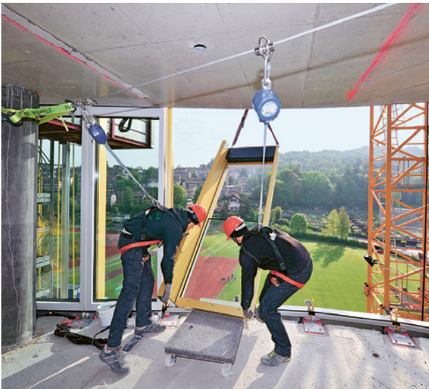
24 Arbeiten an einer Absturzkante. Die Personen sind durch einen Auffanggurt und einen Laufwagen mit einem gespannten Drahtseil gesichert. Verschiedene Befestigungs- und Laufwagensysteme erlauben ein Überfahren der Befestigungspunkte am Drahtseil.
