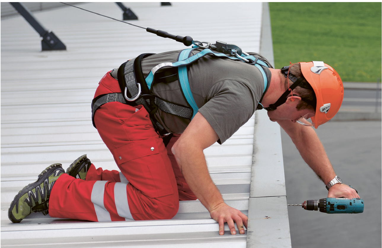
18 Arbeiten an einer Absturzkante.
