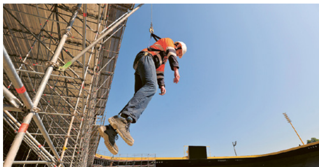
19 Une personne tombée doit être secourue en 10 à 20 min avec les moyens à disposition sur site, sans que ni cette personne ni le sauveteur ne soient mis en danger.
