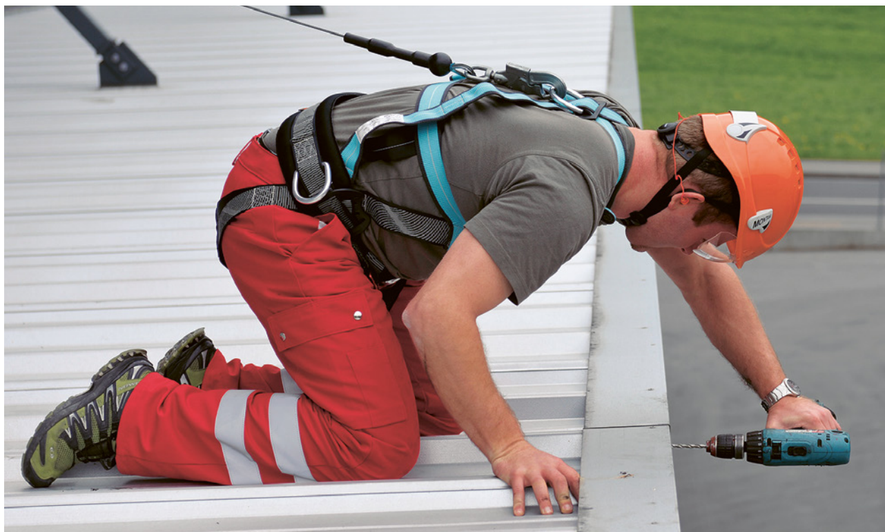
18 Travaux en bordure d'une zone avec risque de chute. La personne est assurée par un antichute à rappel automatique et un harnais.
