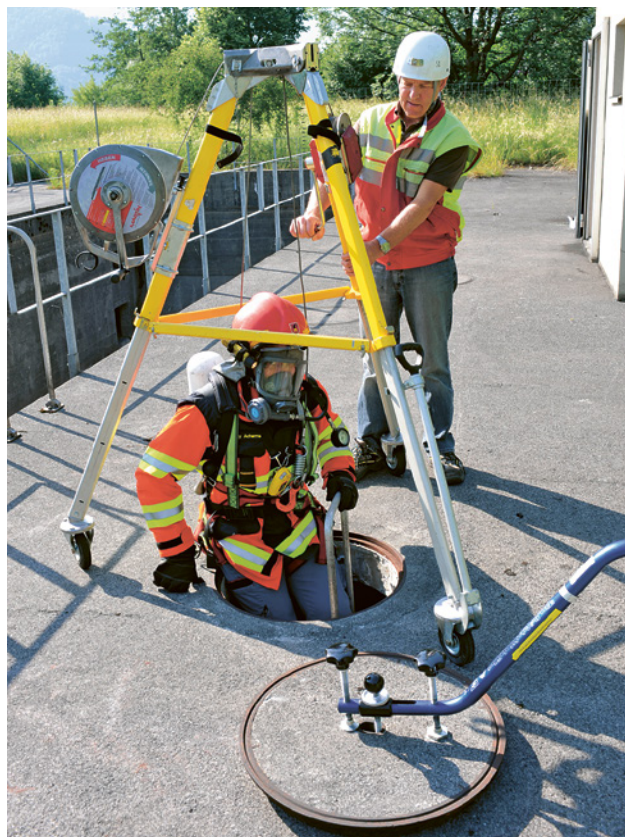
21 Descente dans un puits par une échelle. Assurage avec harnais et antichute à rappel automatique équipé d'une manivelle de sauvetage. La personne qui travaille dans le puits peut être remontée à tout moment grâce à la manivelle.
