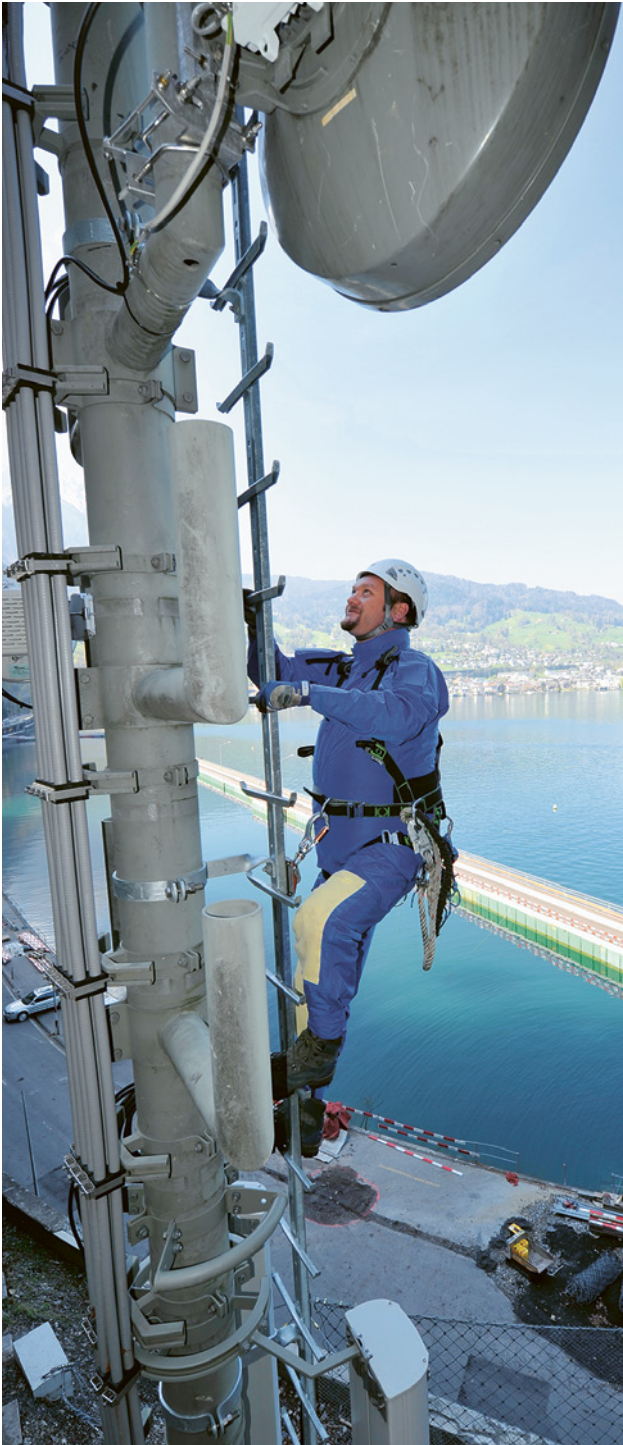
14 Monteur assuré par un antichute mobile sur le rail central d'une échelle fixe.
